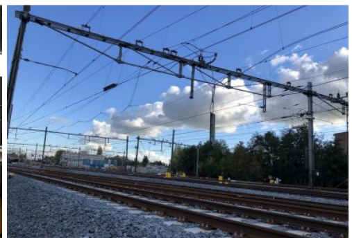
Figuur 3. Gebroken draad bovenleiding.
